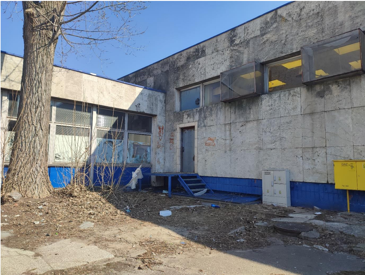
Fotografia 3. Zaśmiecenie widoczne przy budynkach zlokalizowanych przy ul. Polnej
