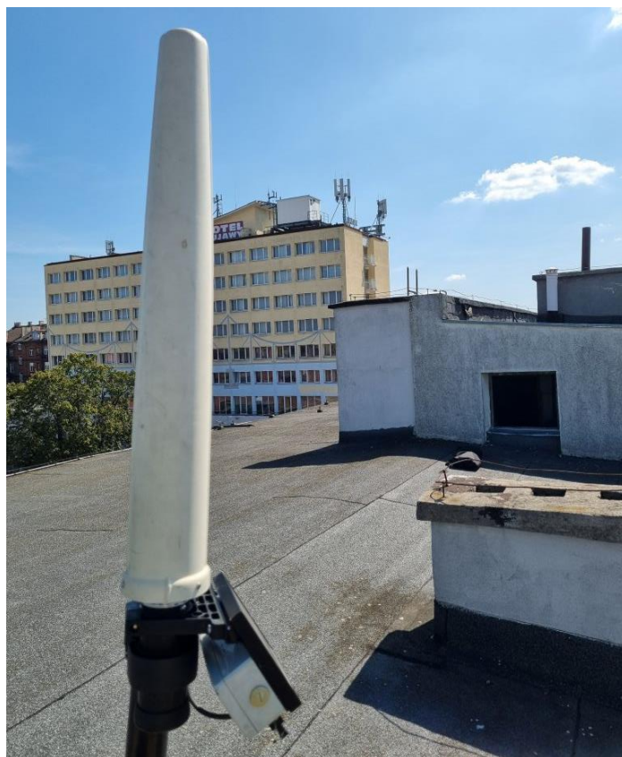
Rys. 3 Miejsce montażu SMS PEM – Budynek, ul. Pułaskiego 3 – widok na SBTk z miejsca montażu stacji
